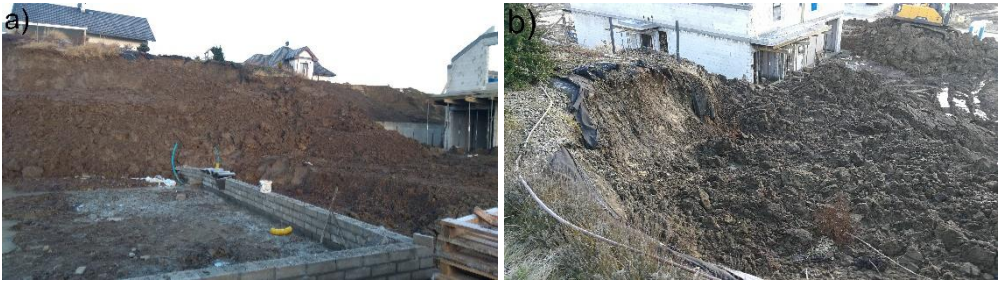
Rys. 5. Osunięte masy ziemne a) widok u podnóża skarpy; b) widok z korony skarpy.
