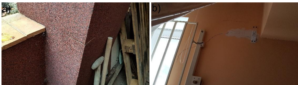
Rys. 2. Widoczne zarysowania a) na zewnątrz budynku b) wewnątrz budynku.
