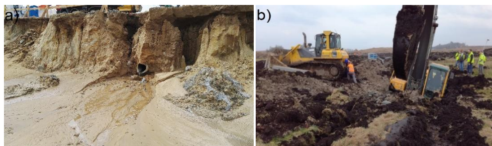
Rys. 12. a) Rozmyte ściany wykopu po opadach deszczu; b) unieruchomiony sprzęt budowlany w wyniku utraty nośności podłoża.
